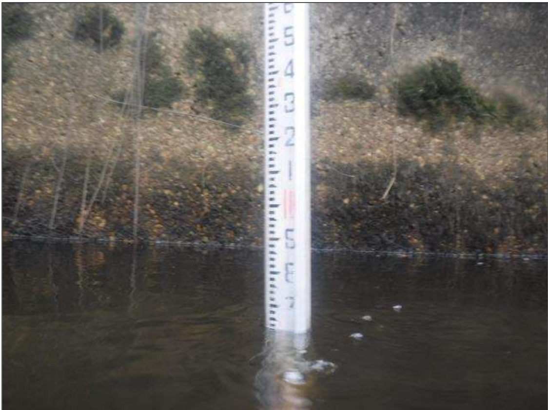
SE WING, SCOUR (PAR)
