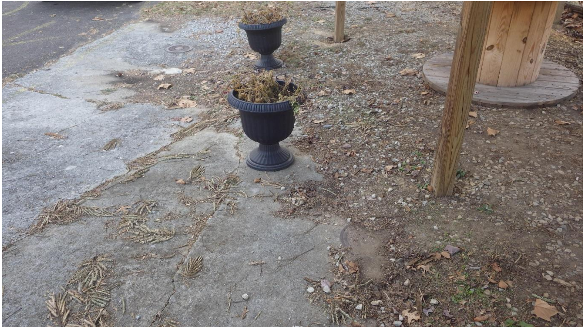
UST fill ports
