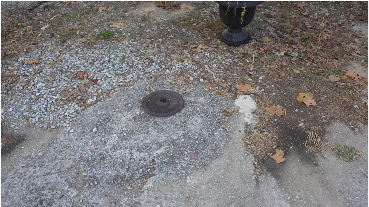
UST fill port
