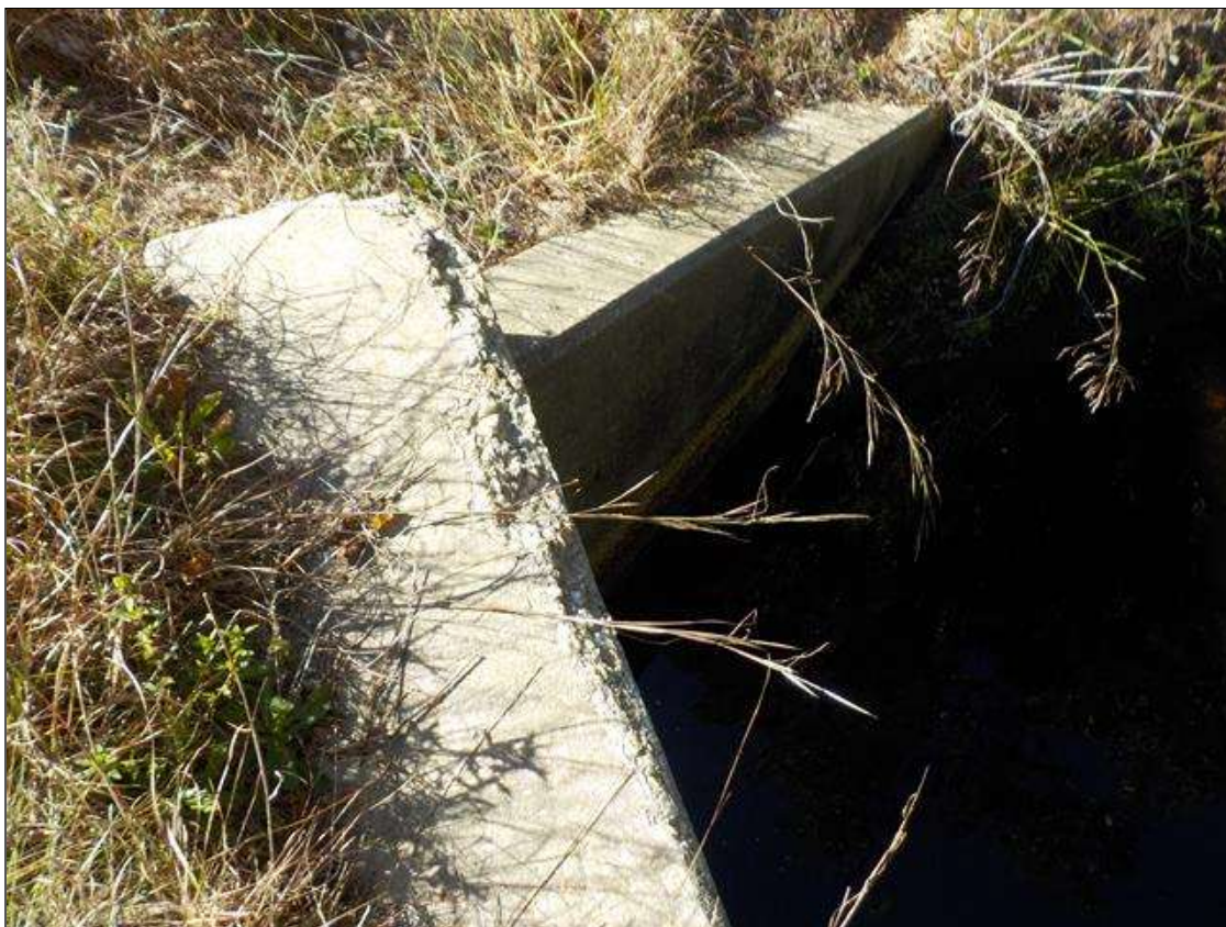
SPALL, SW CORNER HEADWALL, 3'L X 5"W X 2"D
