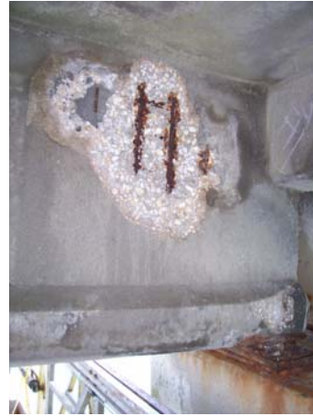
Span 161-162; SP & ER on Girder #1, West side,
