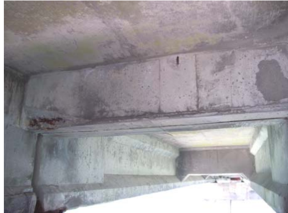
Span 149-150; SP & ER on soffit EJ Beam, West
