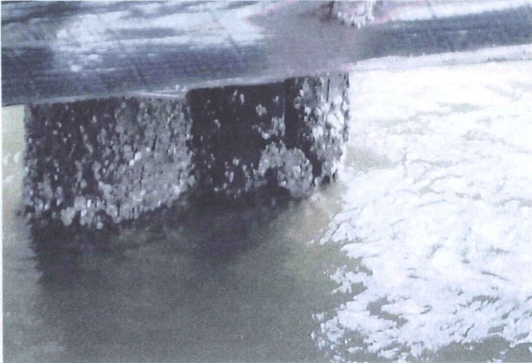
DECAYED PILE, N.FENDER
